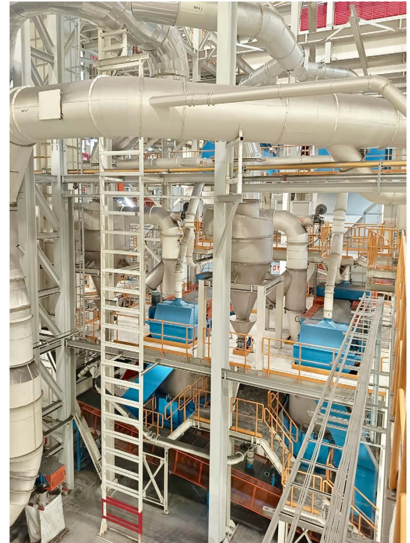
Impianto di Raffreddamento e Recupero Terra per la nuova fonderia di Brembo, Messico
